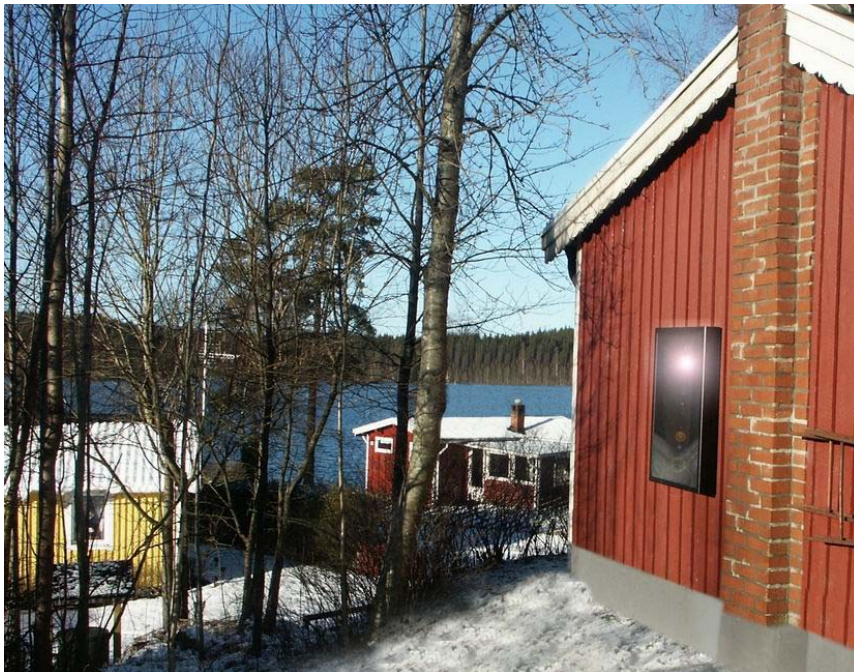
SolarVenti SV7 på gaveln till detta trähuset håller det friskt och torrt.
