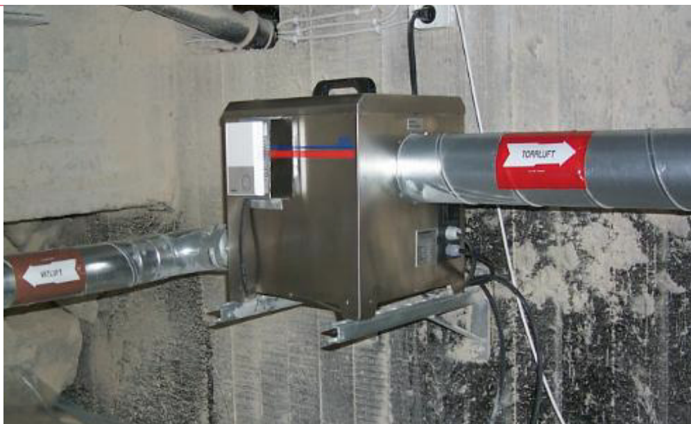
Avfuktare installerad i krypgrund.
