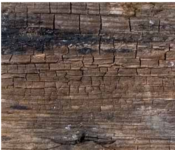
Fukt i grunden kan göra att rötsvampar angriper bärligheten i virket.
